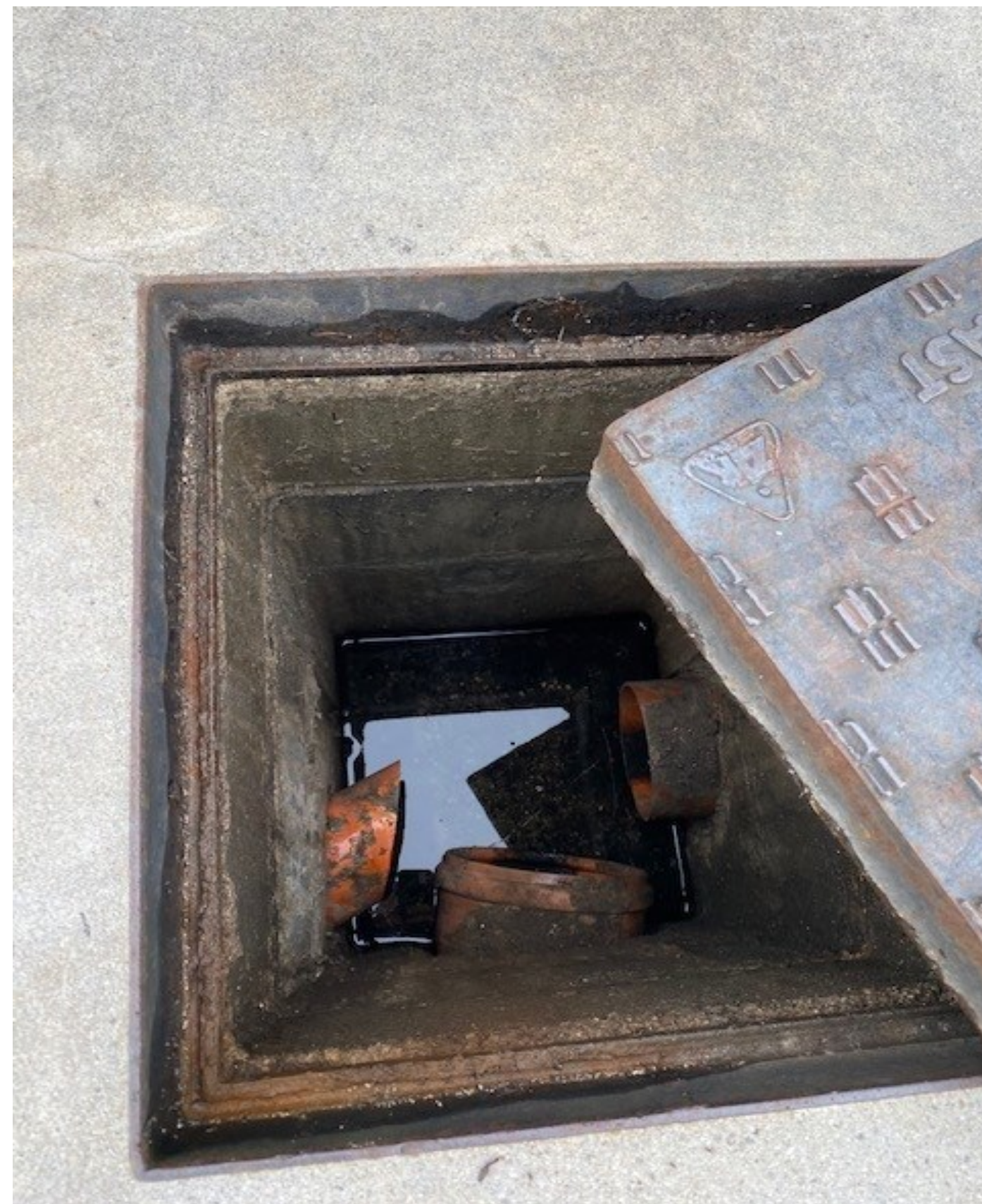
Pozzetto di controllo
